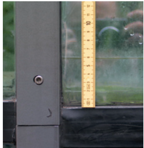
Последствия неправильного выполнения отверстий для выравнивания давления пара и отведения воды.
